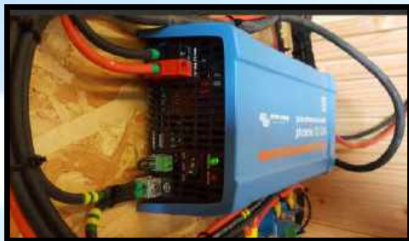
Batterie panneaux solaire
